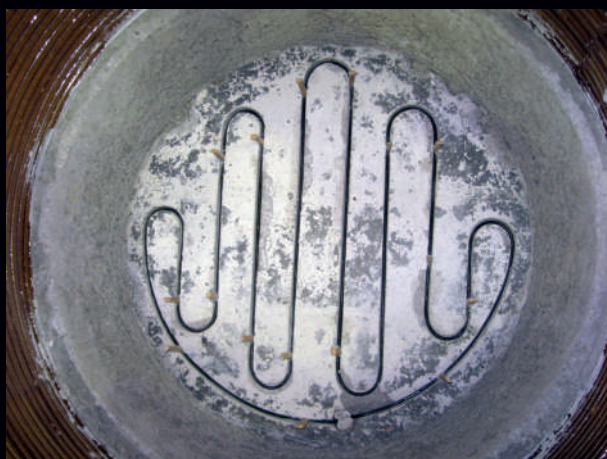
炉底监测 / 炉底顶出块监测
